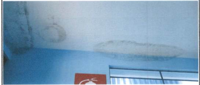
Foto 2: filtraciones en loza
