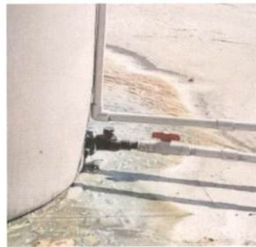
Foto 4: Problema de fugas en deposito de agua
